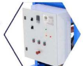
Gabinete electrónico de automatización
