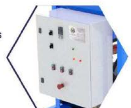
Gabinete electrónico de automatización
